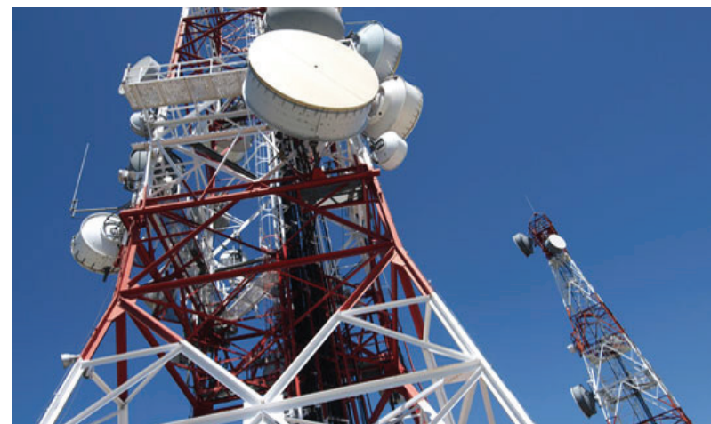
Infrastructures de télécommunications
